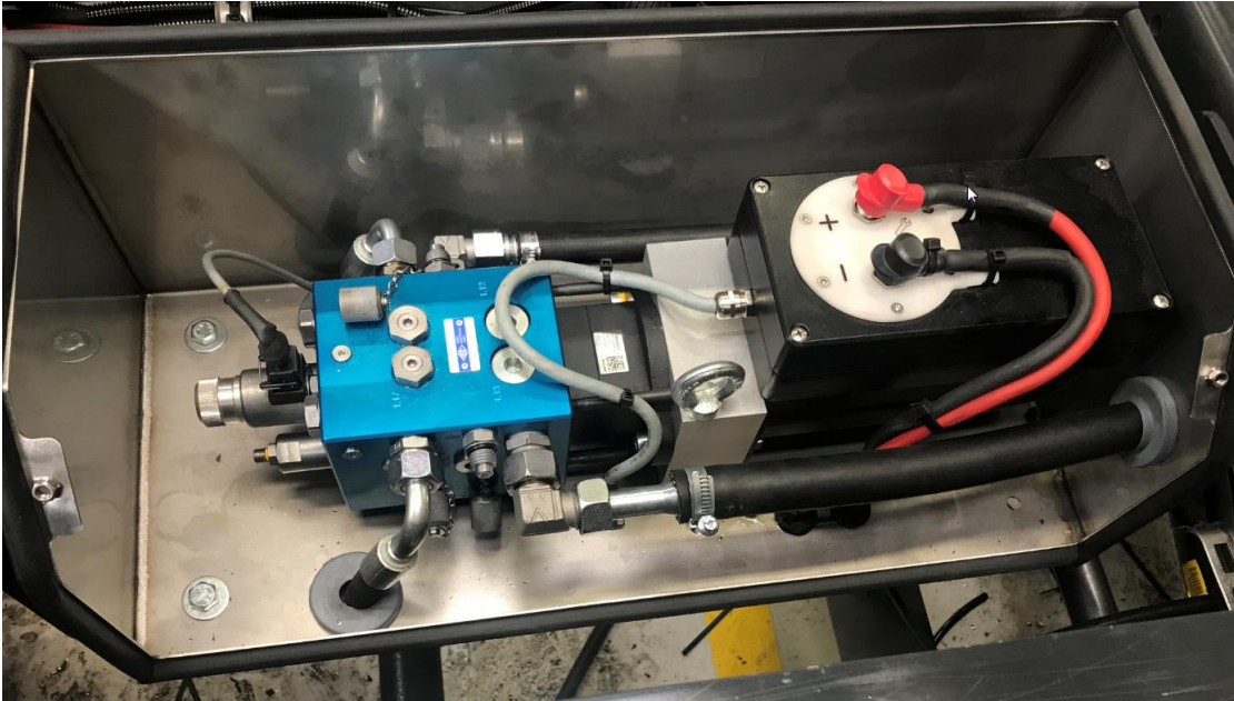
Bild 4: Power Pack, kundenseitig verbaut und verdrahtet
