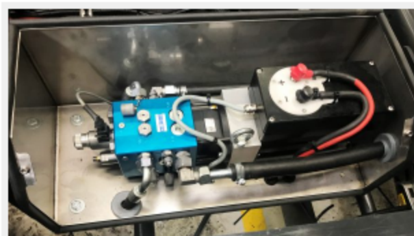
Power Pack – kundenseitig verbaut und verdrahtet.
